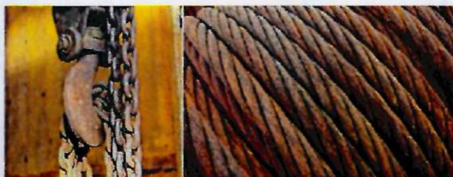
Следы коррозии на крюковой подвеске и канатах крана, работающего на буровой платформе
