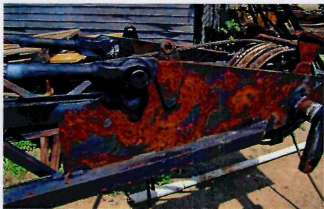
Коррозия, поразившая часть металлоконструкции стрелы, блоков и канат грузоподъемного крана
